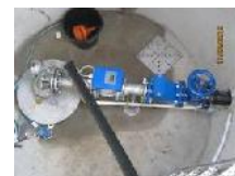
Blick in die Brunnenstube mit Armaturen
