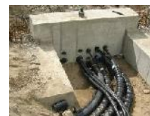
Leitungsdurchführungen in Zwischenwänden
