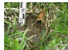
Eingestaute Ackerdränage am Talrand
