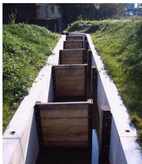
Fischaufstiegsanlage als Schlitzpass
